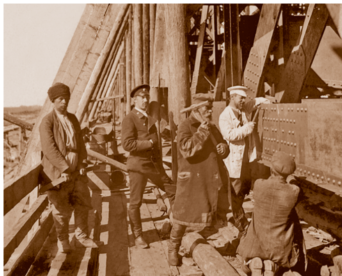
Проверка заклепок на первом пролете железнодорожного моста через Иртыш. Фотография 1895 г. из фондов МИСО.
