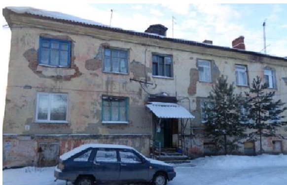
Аварийный жилой дом по ул. 1-я Славянская, 1
