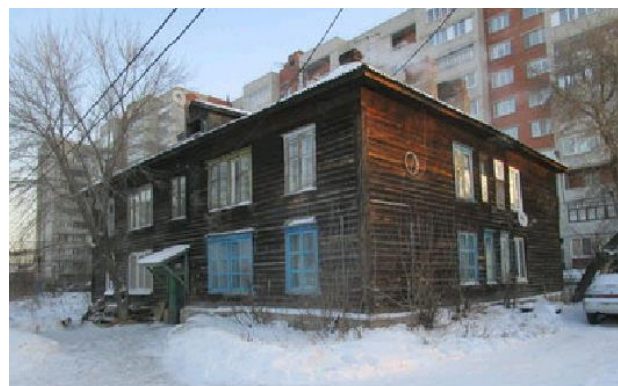
Аварийный жилой дом по ул. Мельничная, 72
